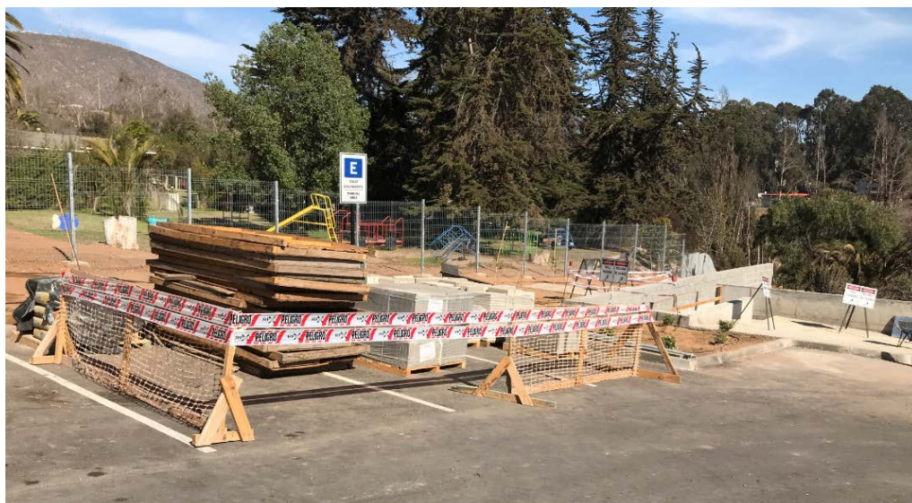
Segregación de 3 espacios de estacionamiento para acopio de material, Se instalan barreras y señalética de advertencia
